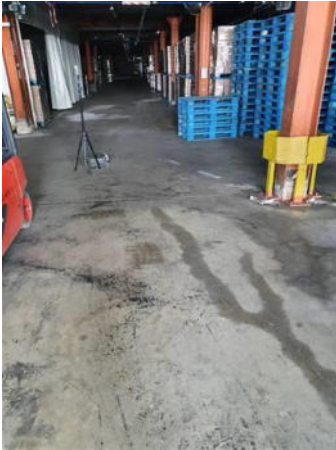
Photo n° M004 LINGETTE Localisation : Rez de chaussée ZONE PALACE Ouvrage : SOL Partie d'ouvrage : LINGETTE Description : LINGETTE Localisation sur croquis : M004 LINGETTE
