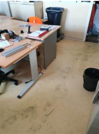
Photo n° M008 LINGETTE Localisation : 1er étage BUREAU PRODUCTION Ouvrage : SOL Partie d'ouvrage : LINGETTE Description : LINGETTE Localisation sur croquis : M008 LINGETTE
