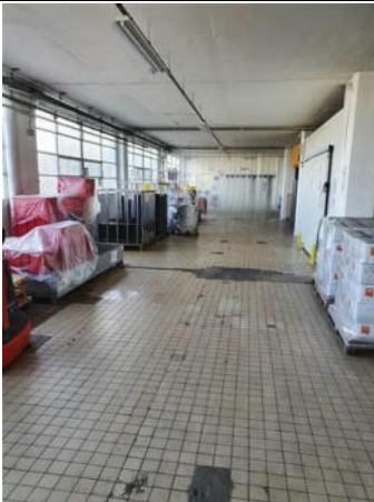
Photo n° M006 LINGETTE Localisation : 1er étage FRANCORUSSE Ouvrage : SOL Partie d'ouvrage : LINGETTE Description : LINGETTE Localisation sur croquis : M006 LINGETTE
