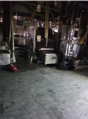
Photo n° M010 LINGETTE Localisation : 1er étage ZONE PETRIN Ouvrage : SOL Partie d'ouvrage : LINGETTE Description : LINGETTE Localisation sur croquis : M010 LINGETTE
