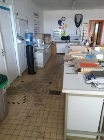
Photo n° M009 LINGETTE Localisation : 1er étage BUREAU TEST Ouvrage : SOL Partie d'ouvrage : LINGETTE Description : LINGETTE Localisation sur croquis : M009 LINGETTE
