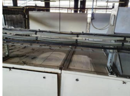
Photo n° M013 LINGETTE Localisation : 1er étage FOUR SANEG Ouvrage : MACHINE Partie d'ouvrage : LINGETTE Description : LINGETTE Localisation sur croquis : M013 LINGETTE
